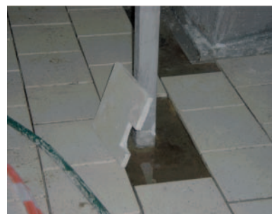
Fot. 3. Nieprawidłowo prowadzone prace modernizacyjne (zawilgocone podłoże)
