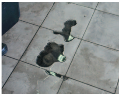
Fot. 1. Szkody powstałe na skutek braku pełnopłaszczyznowego przylegania zaprawy klejącej do spodniej strony płytek
