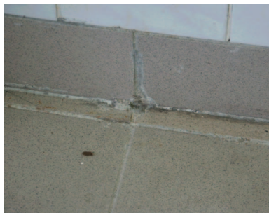
Fot. 2. Brak wyokrąglenia w strefie przejściowej ściana-podłoga powoduje gromadzenie się brudu, mikroorganizmów oraz znaczne trudności w utrzymaniu czystości
