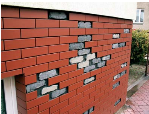
Efekty nieprawidłowego przyklejenia płytek na elewacji
